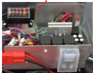
Elektrik und Sicherungen
